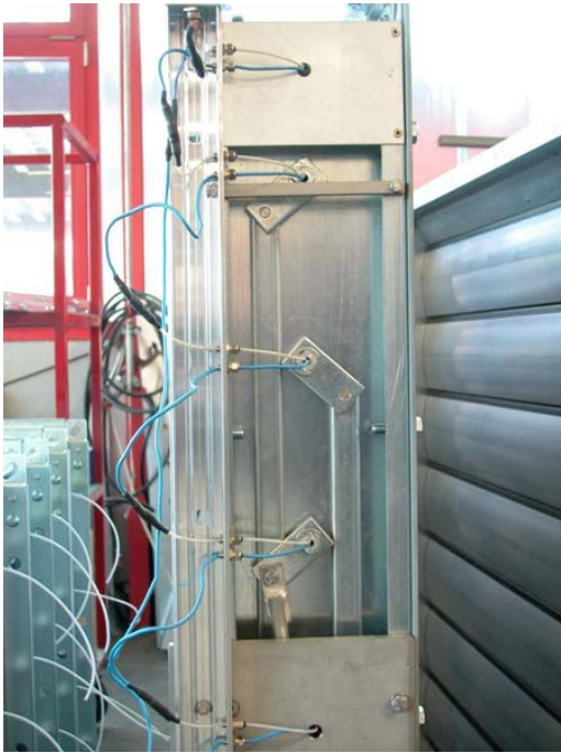
Details vom Gestänge und von der Heizung
